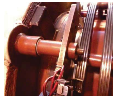
ELEMENTOS AISLACION ANILLO GENERADOR
